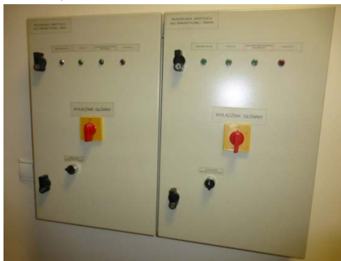
Zdjęcie 1. Istniejące szafy zasilająco-sterujące wentylacją.
